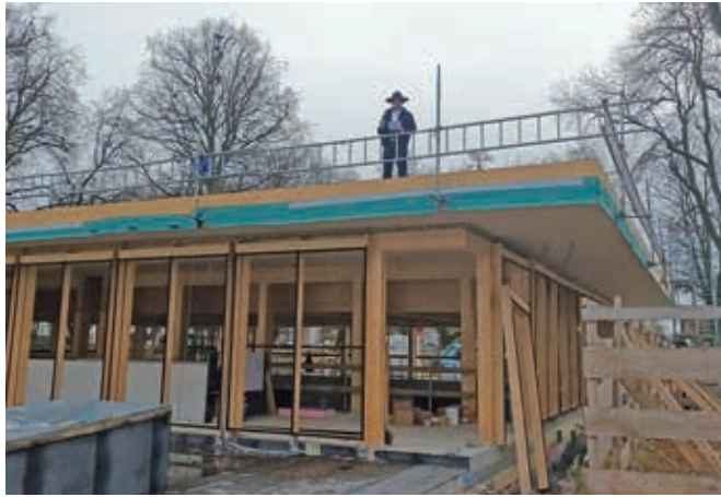
Die Turnhalle nimmt sichtbar Form an. Zimmerer Philip Wehinger sprach den feierlichen Richtspruch auf dem Dach der Turnhalle. Foto: Svenja Gropper
